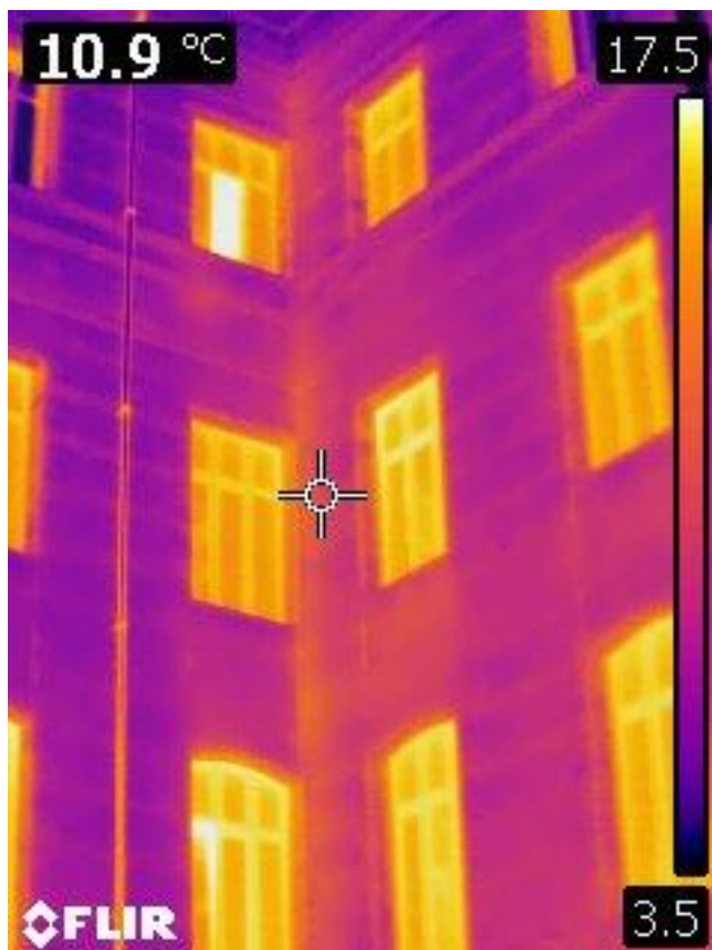
Figura 2.3 – Immagine termografica facciata
